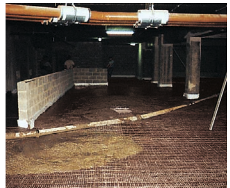
Palazzo della Comunità Europea a Bruxelles (Belgio). Tutta la superficie del parcheggio sotterraneo era sottoposta a variazioni del livello della falda freatica.
