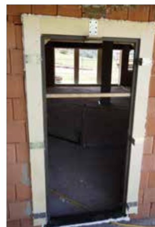
Controtelaio per il fissaggio delle staffe porta-cardini e dell'incontro ferma-scuri. La traversa
